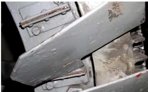
Rys. 6. Zerwanie łopatki wentylatora przymocowanego do korpusu wirnika [1, 2]
