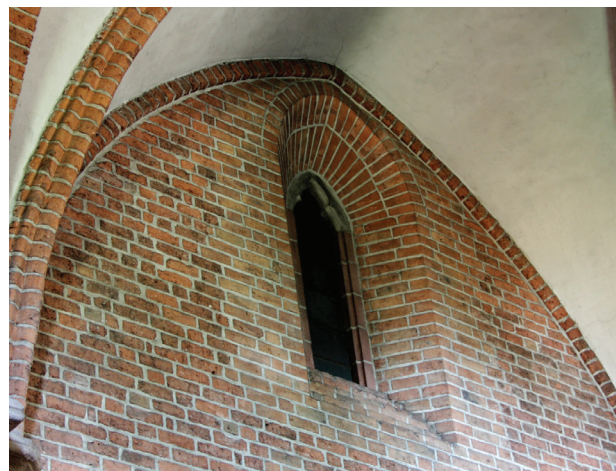
Il. 8. Wtórne okno w ścianie północnej nawy głównej, widoczne przemurowania powstałe przy zwężeniu, stan obecny (fot. M. Dąbkowska)
