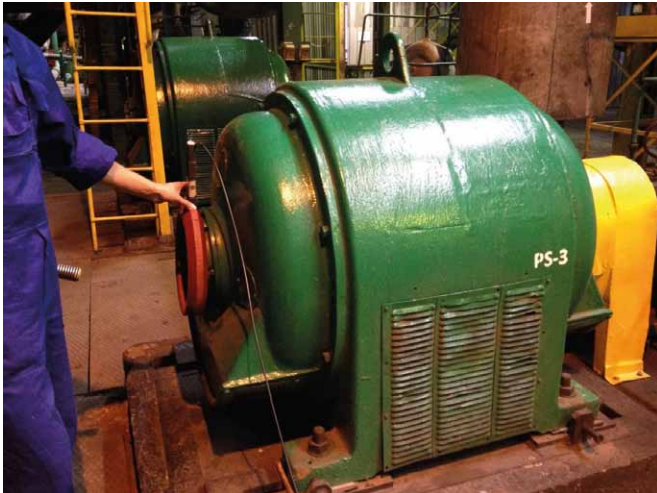
Rys. 14. Widok badanego silnika na stanowisku pracy w elektrociepłowni
