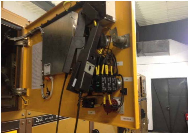
Rys. 15. Widok zamontowanych cęgów do pomiaru prądów w obwodzie wtórnym przekładnika prądowego badanego silnika
