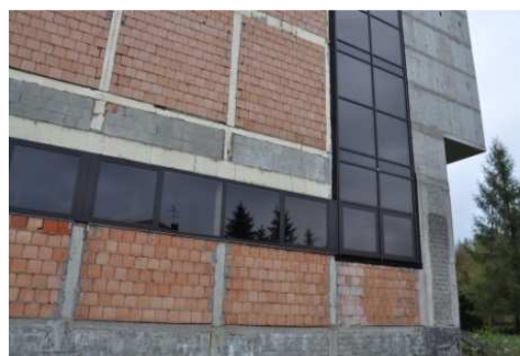
Rys. 7. Okna PCV w kościele św. Kaspra del Bufalo w Częstochowie
