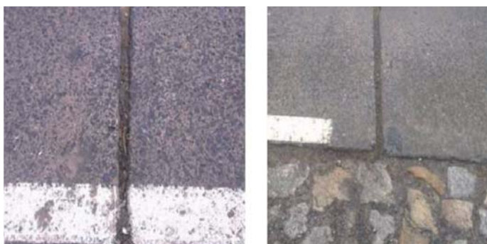
Fot. 7. Widok szczelin dylatacyjnych poprzecznych i fragmentu pobocza nawierzchni betonowej na odcinku drogi Sobienie – Wilga po 55 latach eksploatacji. Zdjęcia wykonano w listopadzie 2015 r
