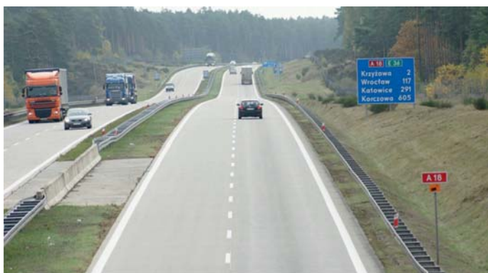
Fot. 9. Widok nawierzchni drogi krajowej nr A18 (wcześniej A12) z betonu cementowego po 20 latach eksploatacji. Zdjęcie wykonane przez Marka Stańczyka w październiku 2015
