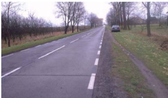
Fot. 6. Widok odcinka drogi Sobienie – Wilga w dniu 11.11.2015 r. Nawierzchnia betonowa wykonana w roku 1960. Jezdnia szerokości 6 m, szczeliny poprzeczne co 5 m. Szerokość szczelin rzędu 20 mm. Nawierzchnia użyteczna technicznie. Beton był wykonany bez domieszki napowietrzającej
