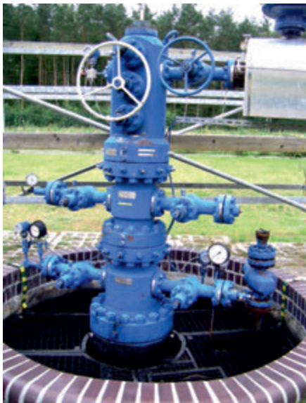
Rys. 10. Głowica na odwiercie eksploatacyjnym M - 5K Fig. 10. Head on M - 5K operating well
