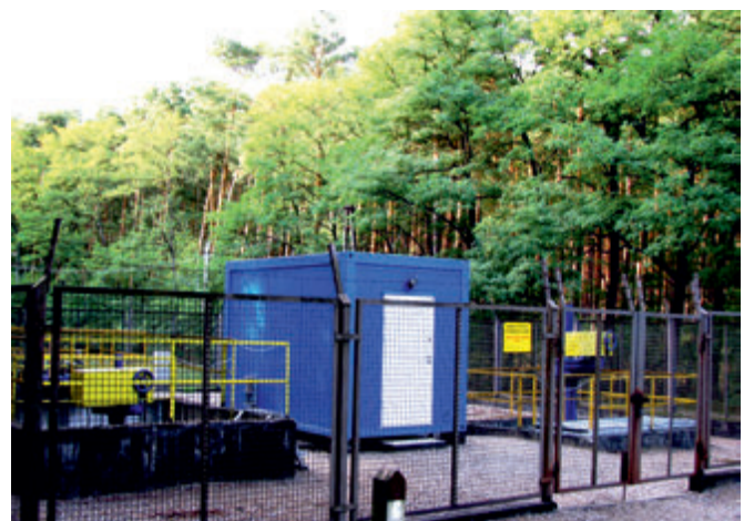
Rys.7. Przepompownia rurociągu „Przyjaźń” na terenie złoża BMB
