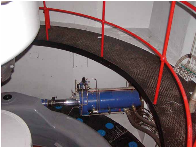
Rys. 3. Serwomotor aparatu kierowniczego turbiny Kaplana
