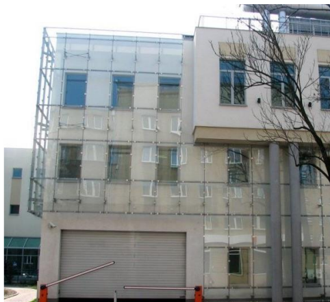
Rys. 4 Budynek z zamontowanymi ekranami akustycznymi [10]
