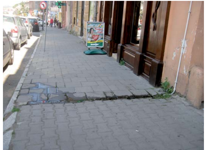
Fot. 4. Niewłaściwie wykonane korytko powoduje rozlewanie się wody z klimatyzatora po nawierzchni chodnika – Sigsoara (Rumunia)
