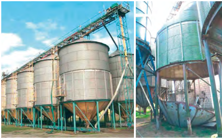
Rys. 7. Silosy K850/2 firmy PETKUS (NRD): a) widok baterii, b) po awarii rozpoczętej oberwaniem leja [7]
