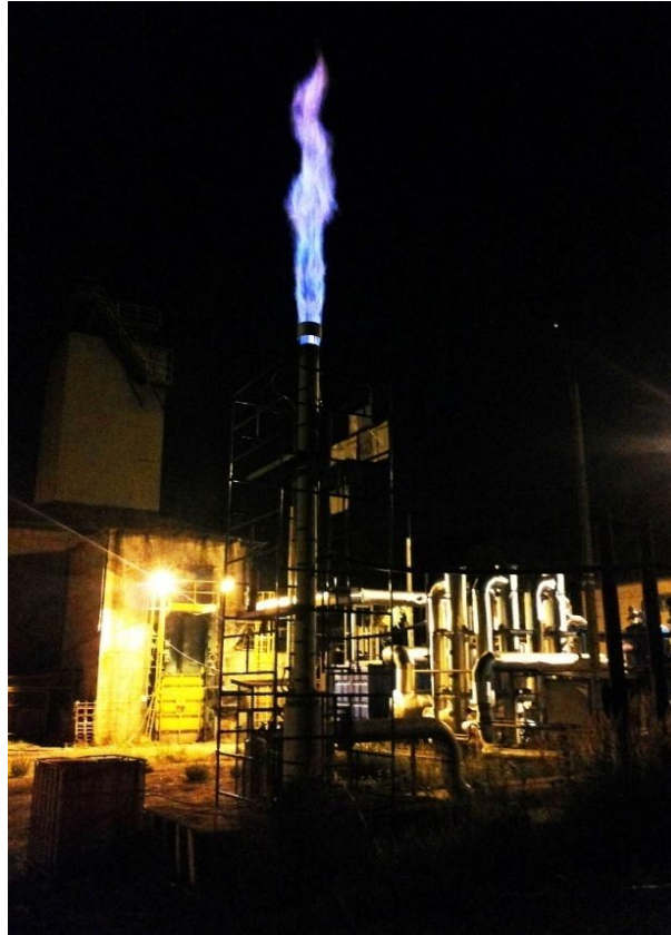
Rys. 8. Widok odpustnicy, w tle fragmentu instalacji oczyszczania gazu PZW
