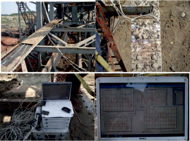
Fig. 15. Wiring and performing measurements on the bucket wheel boom Rys. 15. Okablowanie i pomiary na wysięgniku koła czepakowego
