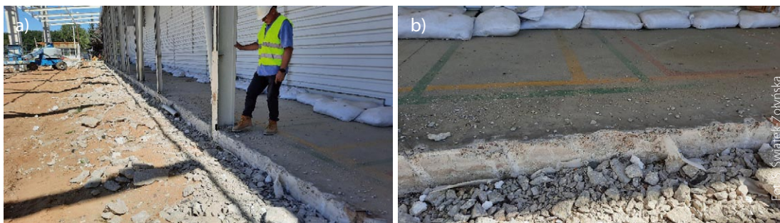
Rys. 6. Styk starej i nowej posadzki: a) widok, b) płaszczyzna boczna starej posadzki
