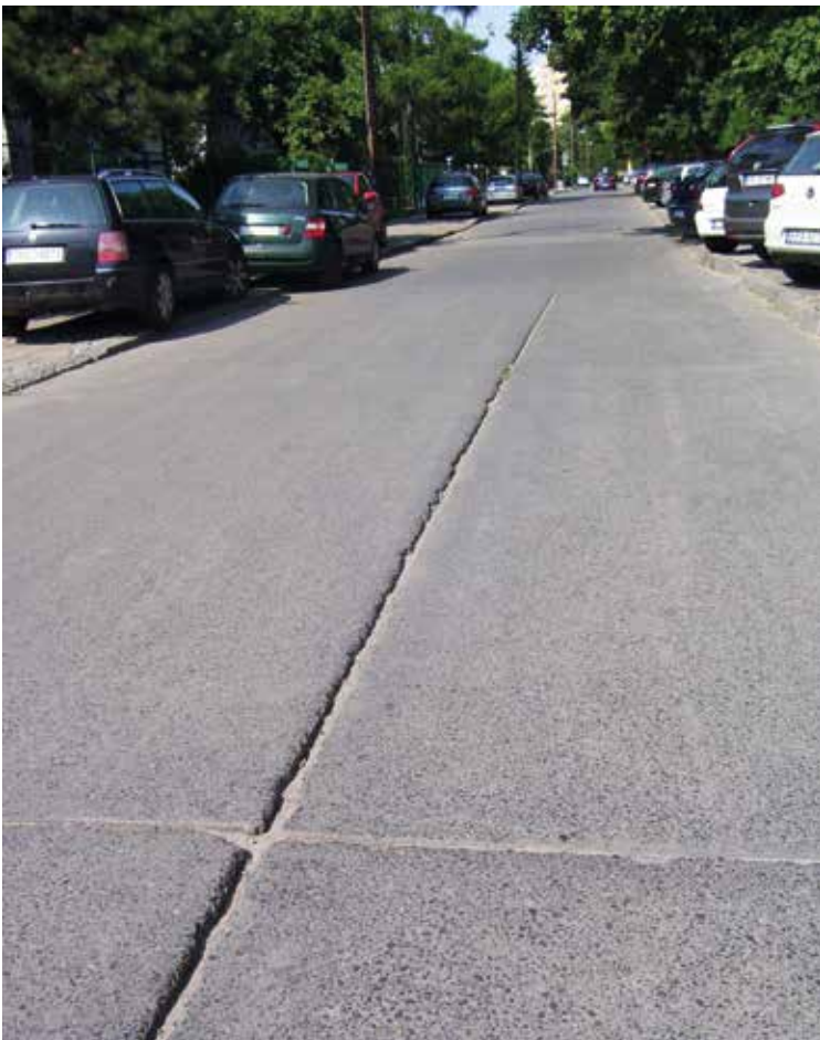
Rys. 12. Ulica D. Chodowieckiego w Krakowie – z betonową nawierzchnią (odsłonięty fragment, widoczny od strony pętli tramwajowej „Cichy Kącik”)
