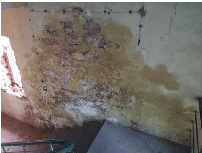
Rys. 5. Widok zniszczeń na klatce schodowej budynku głównego wskutek oddziaływania wód opadowych przedostających się przez uszkodzony dach i nieszczelne obróbki blacharskie do budynku
