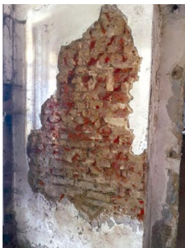
Rys. 4. Widok zniszczeń wskutek oddziaływania wilgoci i soli, murów południowego skrzydła Manufaktury Grossa
