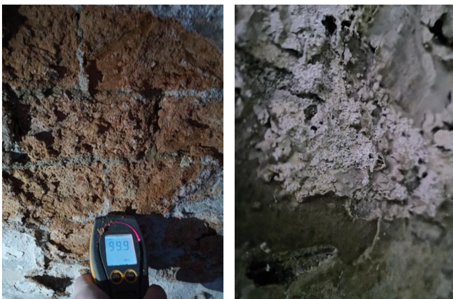
Rys. 3. Degradacja muru w pomieszczeniach piwnicznych spowodowana nadmierną wilgocią (po lewej), na powierzchni muru widoczne wykwity solne (po prawej)
