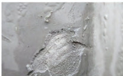
Fig. 3. Damage site with exposed 'powder' under the coating Rys. 3. Miejsce uszkodzenia z odsłoniętym „proszkiem” pod powłoką
