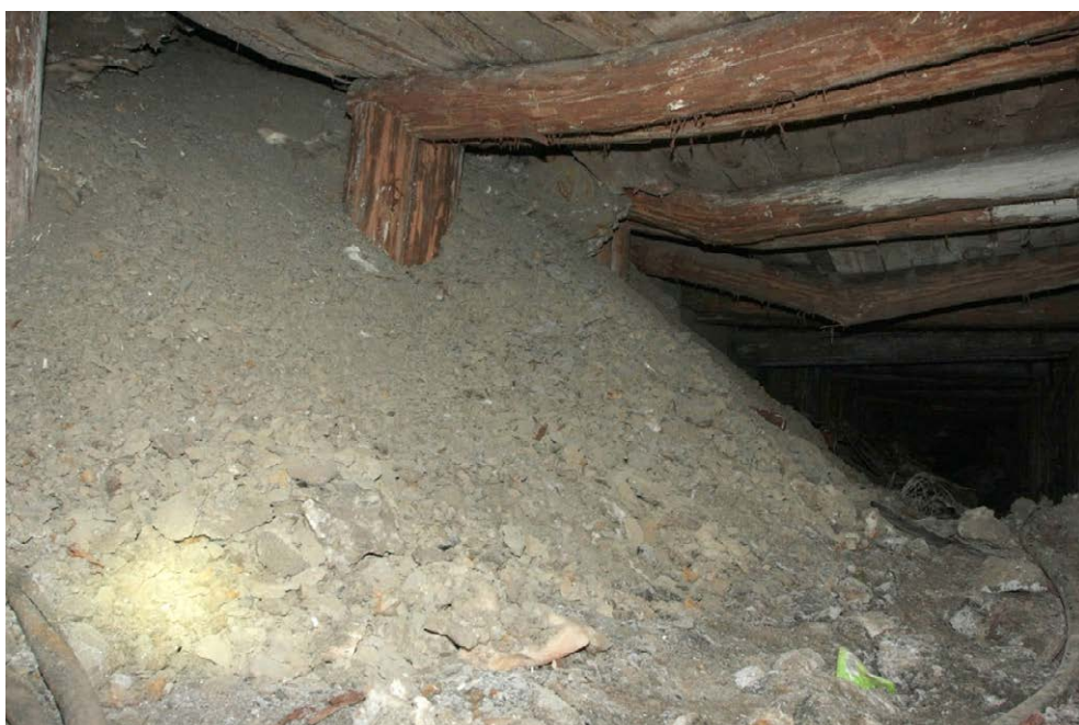
Ryc. 2. Widok fragmentu poprzeczni Albrecht z obudową z podwójnymi odrzwiami i urobkiem zalegającym w ociosie zachodnim. [1].
