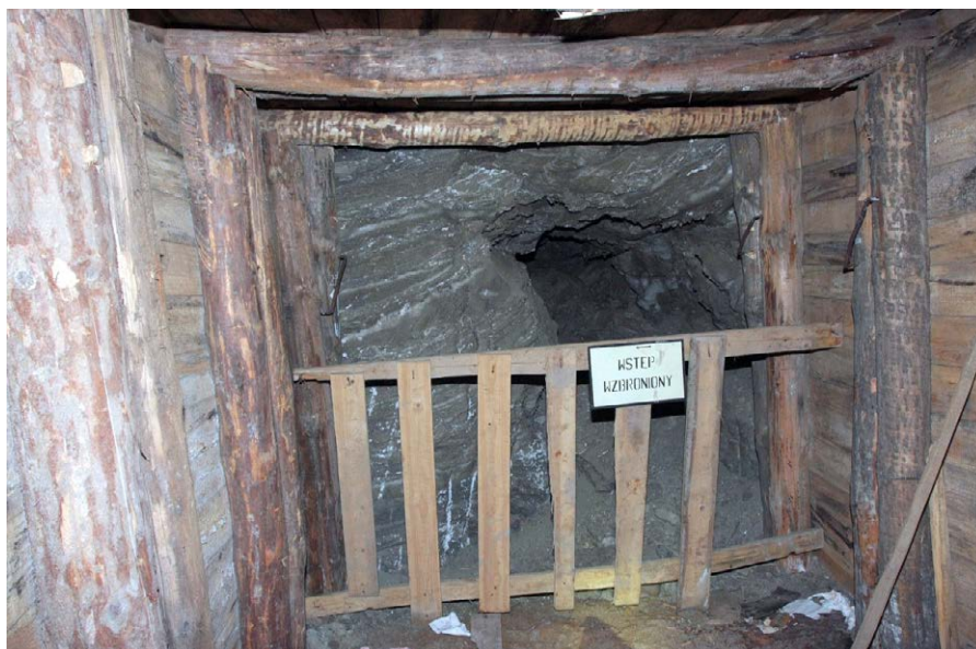
Ryc. 5. Widoczny zawał poprzeczni Albrecht widok od strony południowej w kierunku północnym [1]. Fig. 5. Collapse of the Albrecht connecting corridor. A view from south to north [1].
