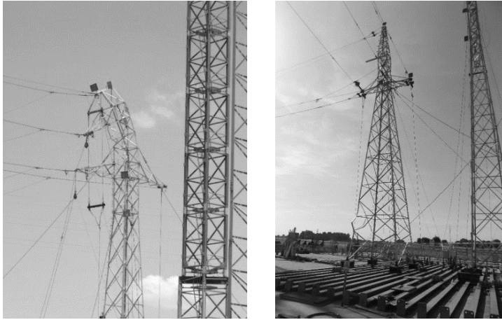
Rys. 5. Schematy zniszczenia słupów jednotorowych EN111 [7]
