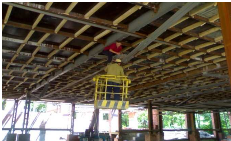
Рис. 4. Малоэлементни шпренгельные фермы пролетом L = 18 м. Комплекс Royal Hotels & SPA Resort, корпус «Женева» в г. Трускавец, Львовской обл., 2007 г.
