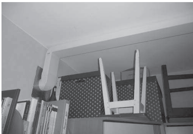
Rys. 6. Rura wentylacyjna pod sufitem całkowicie uniemożliwia grawitacyjny ciąg w kominie
