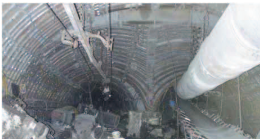
Rys. 15. Obudowa odgałęzienia przekopu kierunkowego pod pokładem 510 poz. 774 m z przekopem odstawczym 774/585 w końcowym etapie zabudowy w wyrobisku [1]
