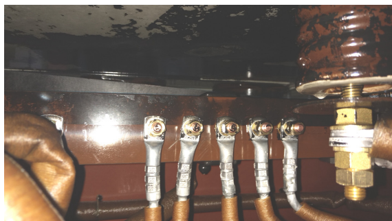
Fot. 2. Widok części aktywnej transformatora olejowego, z widocznym poziomem oleju, przy którym nastąpiło wyladowanie łukowe wewnątrz kadzi
