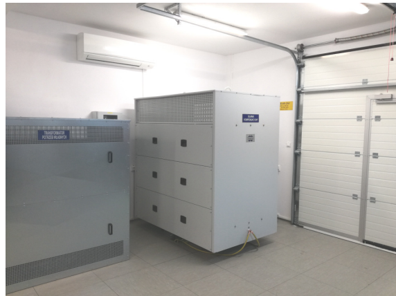
Fot. 1. Lokalizacja dławika w pomieszczeniu bez zapewnionego odpowiedniego przepływu powietrza chłodzącego
