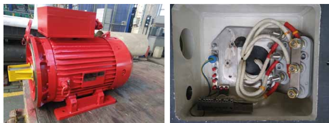
Rys. 5. Widok silnika 2SP1 280M-6A oraz widok wnętrza jego skrzynki zaciskowej
