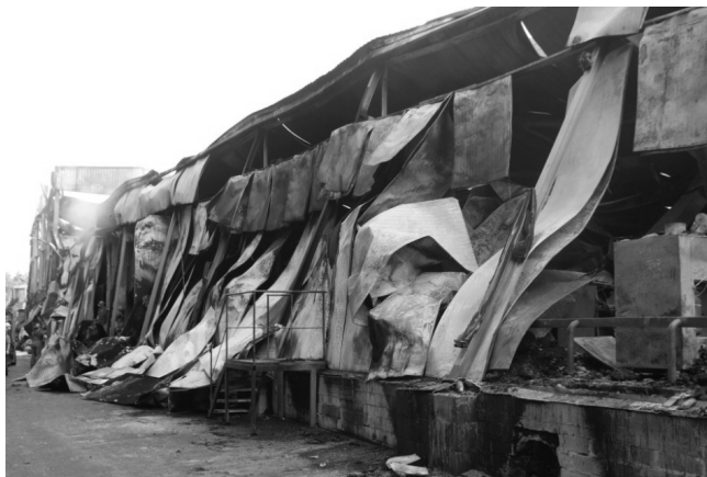
Ryc. 4. Widok zniszczonej hali produkcyjno-magazynowej [2] Fig. 4. View of the destroyed production and storage hall [2]
