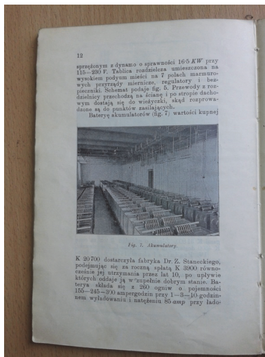
Rys. 4. Akumulatory systemu Z. Staneckiego na elektrowni miejskiej w Samborze (zdjęcie z książki A. Kühnel „Elektrownia miejska w Samborze”, Lwów, 1910)
