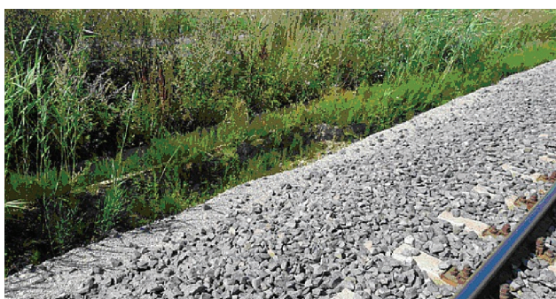
Rys. 3. Brak ścięcia ław torowiska i oczyszczenia rowów po przejściu maszyny AHM 800-R [fot. G. Pływaczyk]
