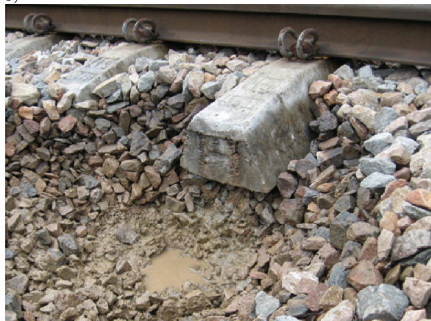
Rys. 5. Wyniki odsłonięcia podsypki: a) zmierzona grubość warstwy 0,21 m i zanieczyszczenia, b) niewłaściwa granulacja oraz brak odwodnienia [fot. G. Gawroński]
