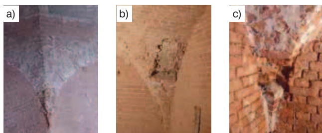
Rys. 2. Strefy oparcia sklepień krzyżowych w narożach ścian murowych: a) widok po rozbiórce sklepienia, b) degradacja muru, c) osłabienie otworami instalacyjnymi
