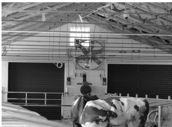
Fot. 4. Widok na wentylatory wspomagające przepływ powietrza wzdłuż obory Photo. 4. View of the fans supporting the air flow along the barn
