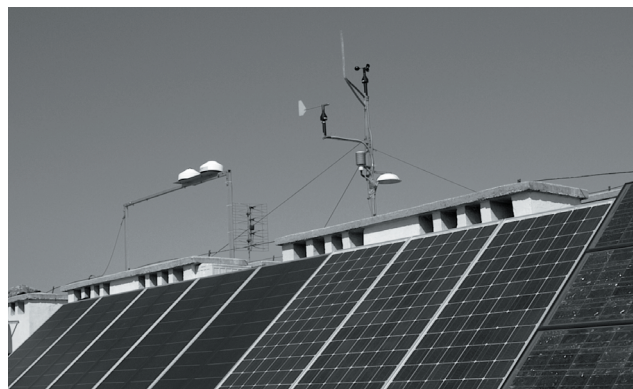
Rys. 2. Dachowe instalacje fotowoltaiczne (moduły krzemowe w różnych technologiach) oraz stacja meteorologiczna. Fig. 2. PV installations (different Si-technologies) and meteo station on the roof.
