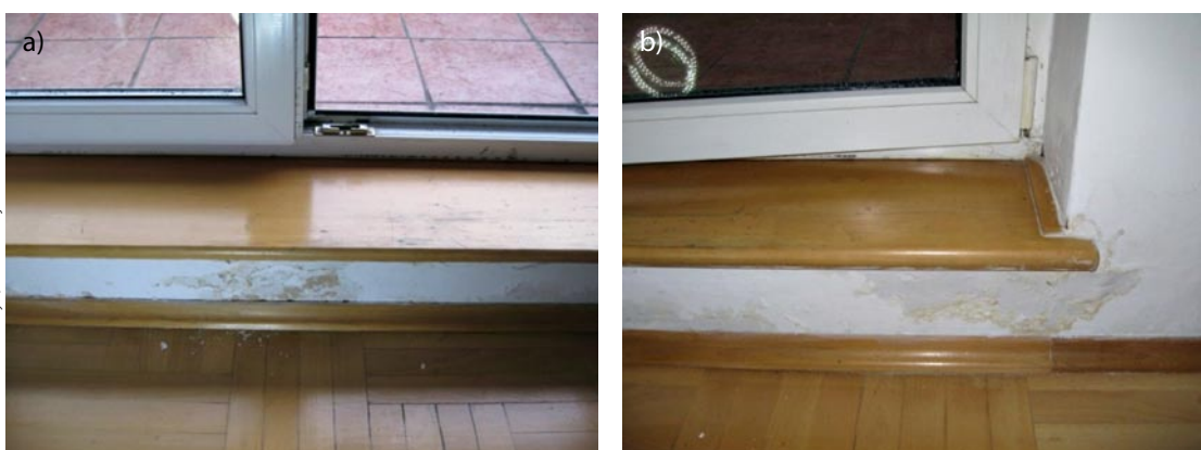
Rys. 5. Zawilgocenie i odspojenie po stronie pomieszczenia przy tzw. progu podniesionym
