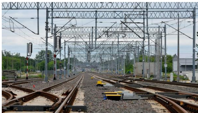
Rys. 1. Przykład rozmieszczenia urządzeń sterowania ruchem kolejowym na szlaku kolejowym [8]
