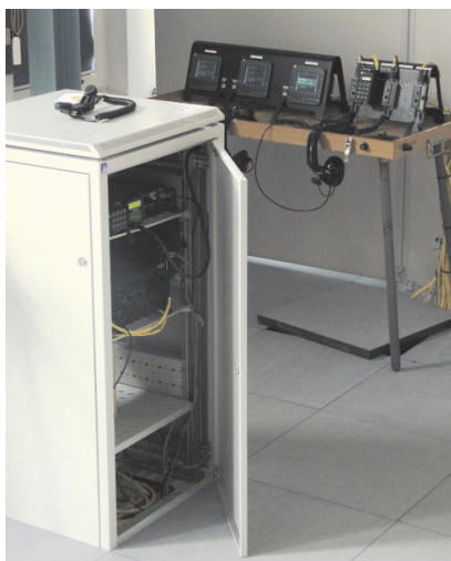
Rys. 4. Widok stanowiska integracyjno-diaagnostycznego z elementami sterowania zintegrowanego systemu łączności
