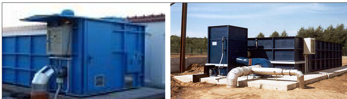
Fot. 2. Elementy instalacji do biofiltracji gazów
