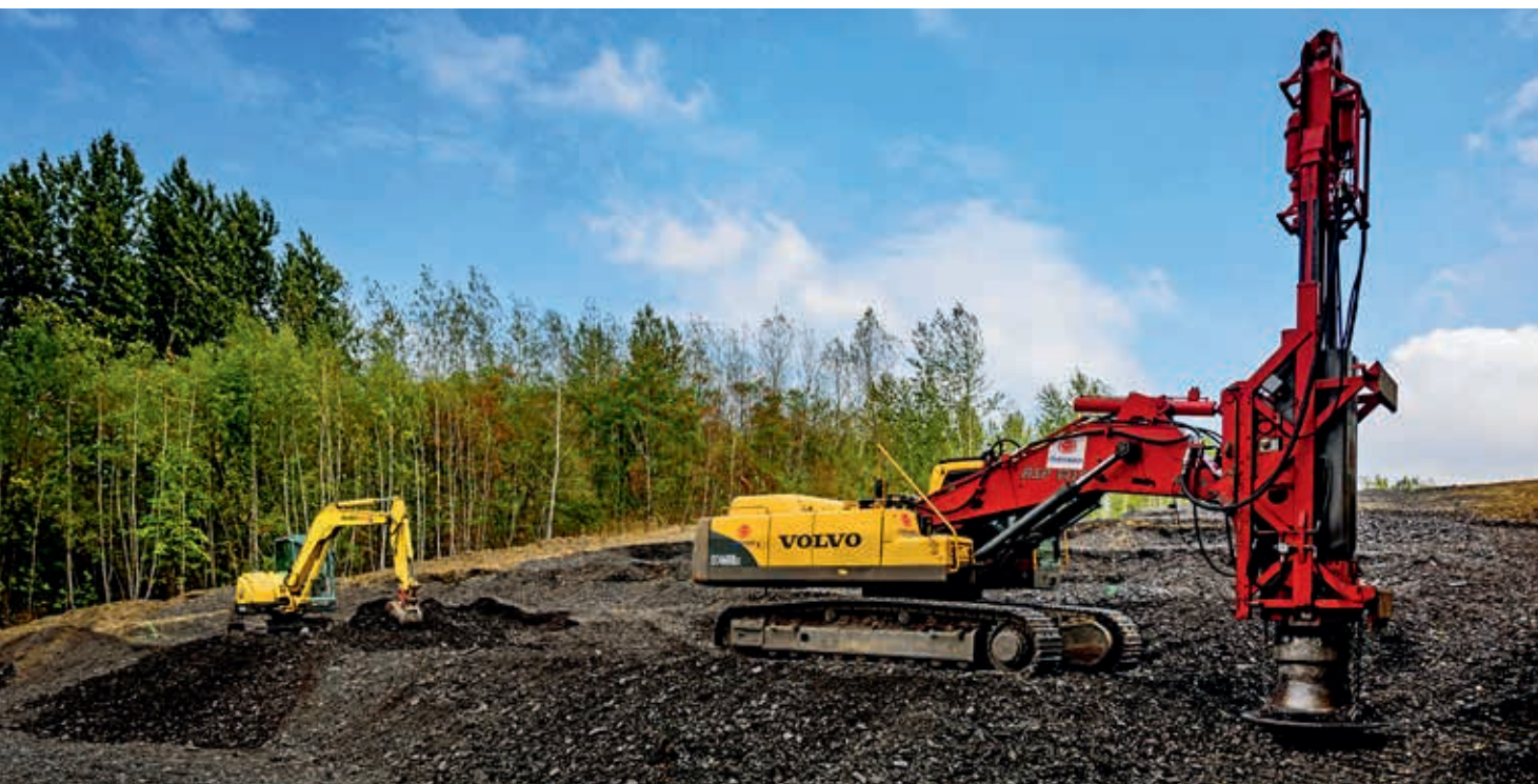
Wzmocnienie podłoża w technologii ubijania impulsowego RIC, fot. Menard Polska Sp. z o.o.
