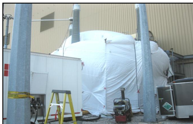
Rys. 6. Zabezpieczenie transformatora 70MVA 500 kV przed wychłodzeniem oraz wpływem czynników zewnętrznych podczas suszenia w procesie LFH
