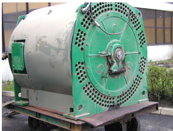
Rys. 1. Silnik indukcyjny dużej mocy z urwanym wałem od strony napędowej
