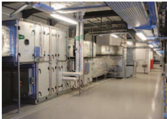
Rys. 2. Widok kondygnacji technicznej z centralami wentylacyjnymi
