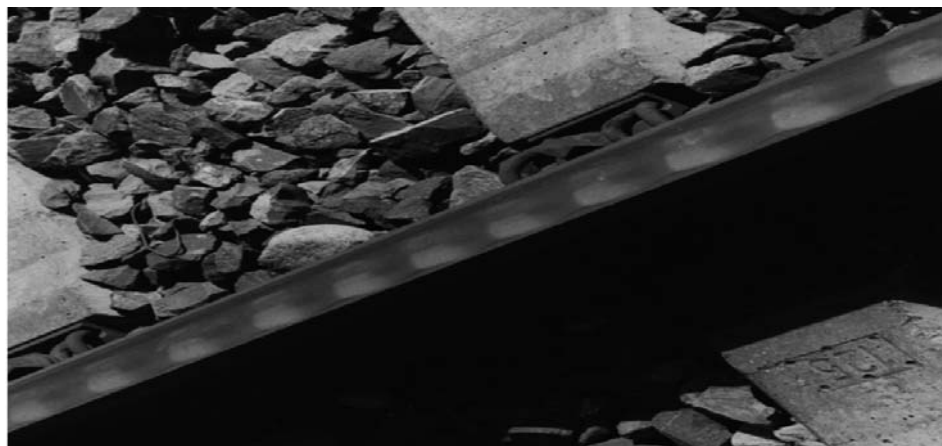
Rys. 8. Fale poślizgowe na szynach torów o ciasnych łukach (długość fali około 120 \text{ mm} , amplituda przekraczająca 300 \mu\text{m} )
