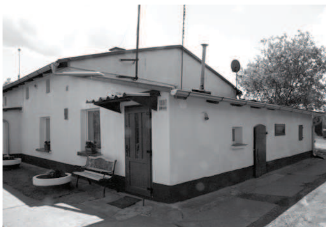
Rys. 17. Widok ścian budynku po 25 latach od zakończenia osuszania systemem Hermon (fot. własna)
