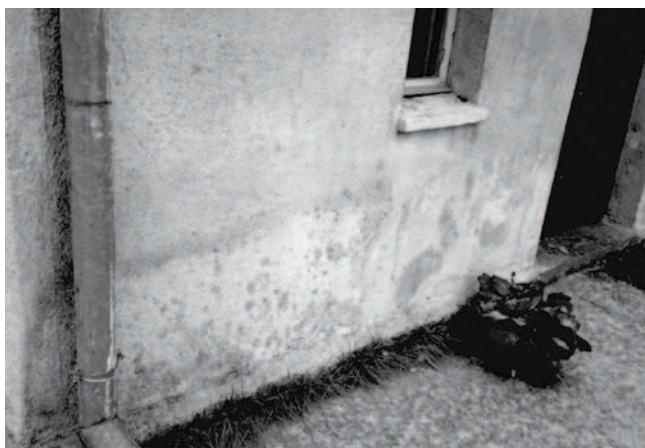
Rys. 16. Widok zewnętrznej ściany budynku po upływie trzech miesięcy od ukończenia prac preparatem Hermon. Mchy i porosty nie zostały usunięte mechanicznie, lecz uległy mineralizacji (fot. własna)
