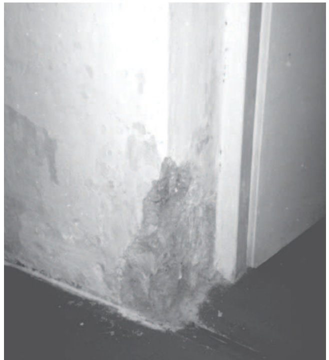
Rys. 14. Widok ściany środkowej wewnątrz budynku po upływie trzech miesięcy od zakończenia prac preparatem Hermon; w procesie mineralizacji mikroflory i mikrofauny wraz z gazami mурowymi spowodowały odrzucenie fragmentu tynku z narożnika (fot. własna)
