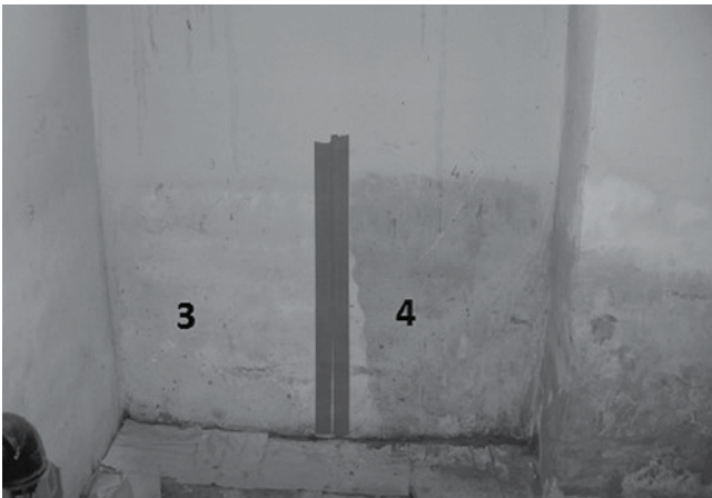
Rys. 11. Widok ściany po dwóch miesiącach od rozpoczęcia prac preparatem Hermon. Cała powierzchnia była sucha, pozbawiona przebarwień i wykwitów, jednorodna i twarda. Powierzchnie zabezpieczone innymi preparatami były lekko wilgotne (w szczególności ta zabezpieczona Ahydrosilem – fragment muru nr 4). Preparat Hermon został naniesiony na fragment muru nr 3 (fot. własna)
