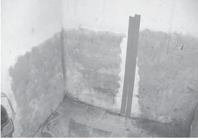
Rys. 10. Widok ściany po kilku sekundach od nałożenia preparatu Hermon I – gwałtowne wyraszanie – połączone z rekrytalizacją wewnętrznej struktury muru żelbetowego (fot. własna)
