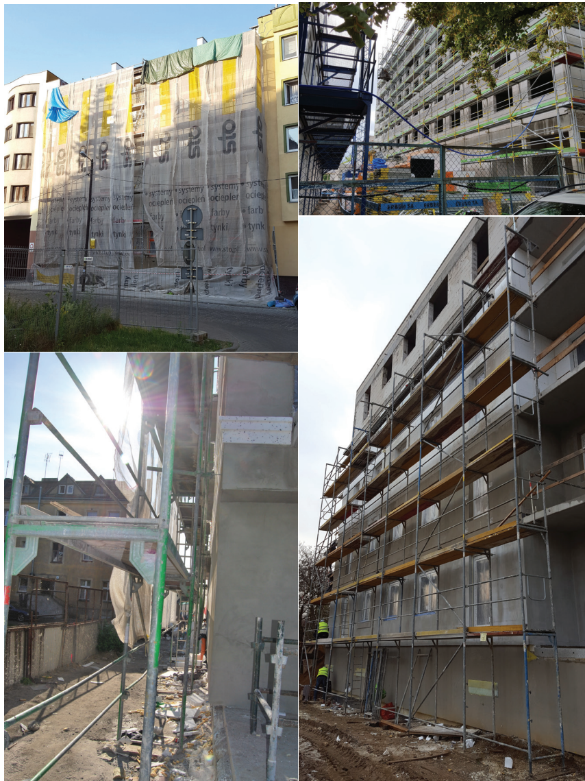
Fot. 1–4. Przykładowe rusztowania wraz z najbliższym otoczeniem, na których pracowali uczestniczący w badaniach
