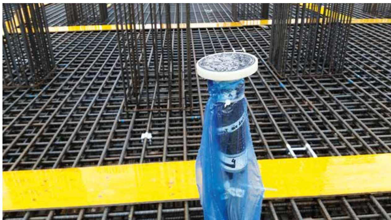
Rys. 3. Automatyczny pomiar temperatury dojrzewającego betonu
