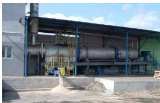
Rys. 2. Ogólny widok instalacji o mocy 12MW.
