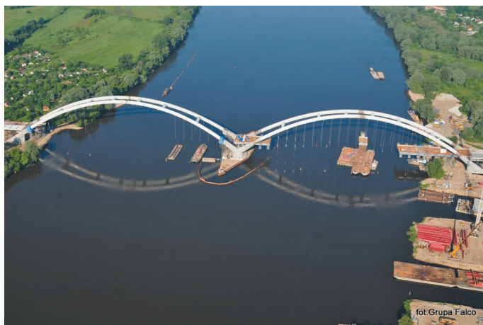
Fot. 8. Zamontowane przęsła dźwigarów łukowych na podporach stałych mostu. Źródło : Miejski Zarząd Dróg w Toruniu . Autor: Grupa Falco
