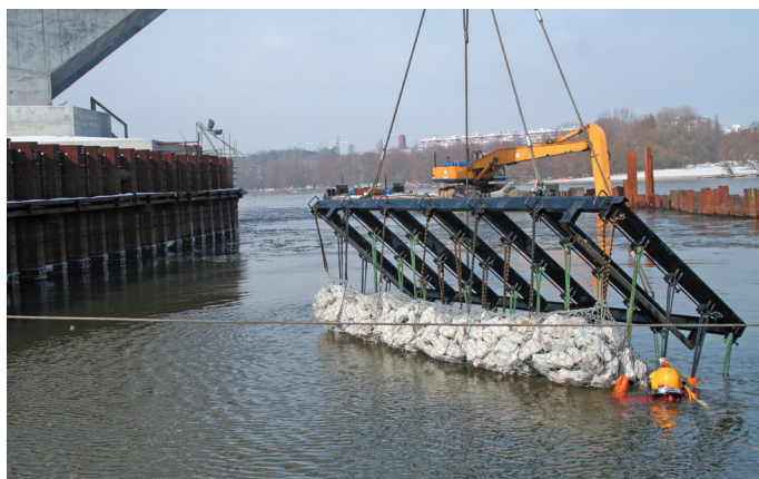
Fot. 5. Prace przy umacnianiu wyspy centralnej matercem kamiennym Źródło: Miejski Zarząd Dróg w Toruniu
