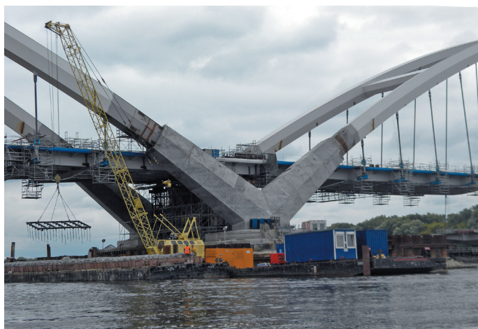
Fot. 4. Podpora w nurcie rzeki. Montaż pomostów w trakcie realizacji. Źródło: Miejski Zarząd Dróg w Toruniu
