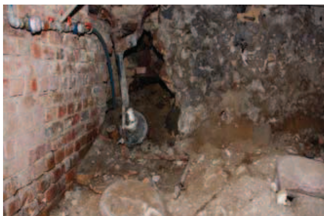
Rys. 6. Uszkodzenia konstrukcji ściany piwnicznej w miejscu przyłącza kanalizacyjnego
