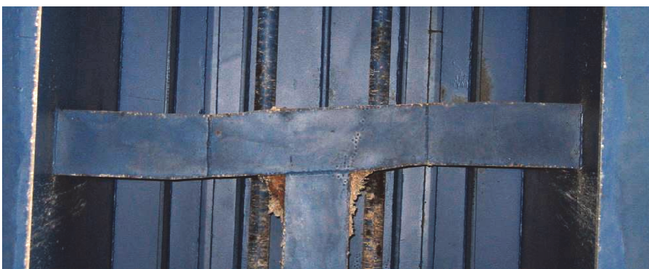
Rys. 6. Widok od dołu na poprzecznicy przęsłową o zaburzonej geometrii będącej konsekwencją błędów na etapie wytworzenia i montażu konstrukcji
