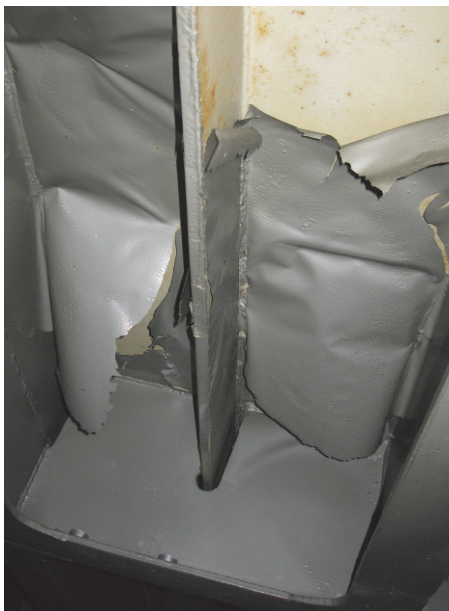
Rys. 4. Wadliwie odtworzenie powłoki antykorozyjnej w ramach bieżącego utrzymania
