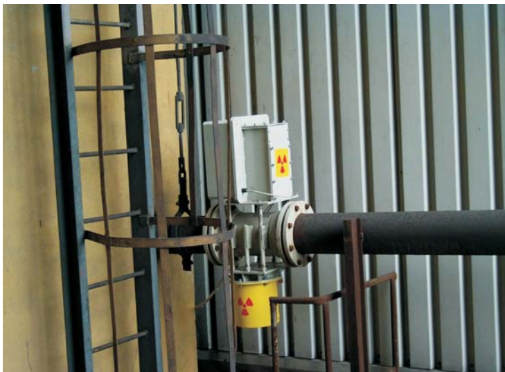
Rys. 1. Prototyp miernika PMP zainstalowany w Elektrowni „Łaziska”
