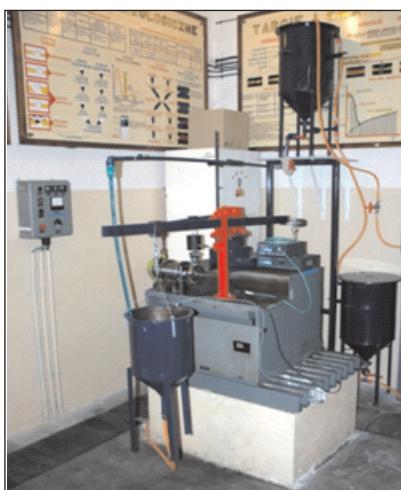
Rys. 7. Widok ogólny stanowiska PŁS-02
