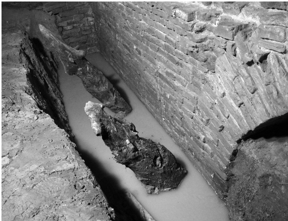
Fig. 1. Work at the grotto foundations – South-East; a fragment of construction [622] is visible, trial pit 60. [photo Michał Aniszewski] Rys. 1. Prace przy fundamentach Groty – SE, widoczny fragment konstrukcji [622], sondaż 60. [fot. Michał Aniszewski]
