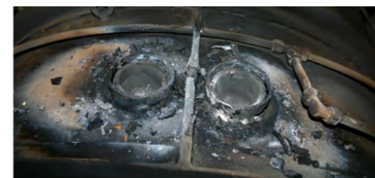
Rys. 10. Efekt zwarcia w przepustach prądowych spowodowane osadzeniem się węgla na elementach ceramicznych
