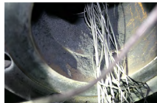
Rys. 5. Sadza zgromadzona w króćcu przepustu termoparowego
