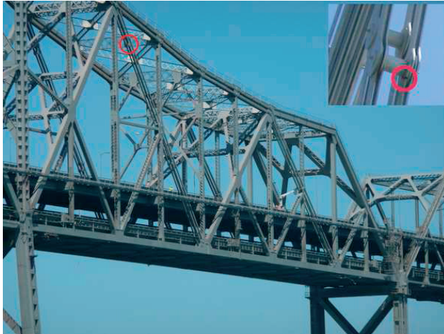
Rys. 2 Widok pęknięcia krzyżulca mostu Bay Bridge w San Francisco [2]
